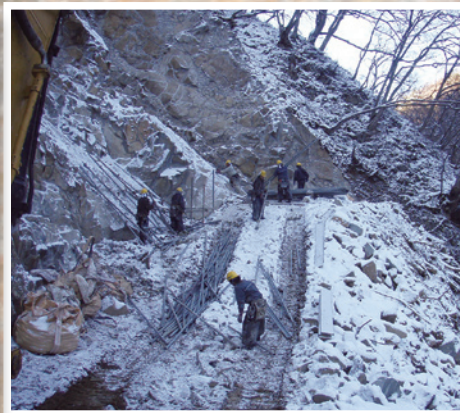
4 仮設足場解体 広範囲に及ぶ施工現場にも関わらず解体はわずか1日とスピーディーに行った
