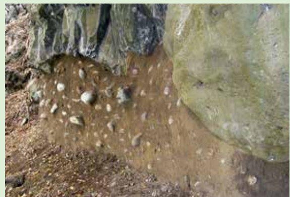
施工後、表面が砂によって覆われた。しかし時間と共に剥げ落ちることが課題となっている。
