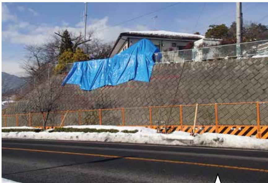
長野県神城断層地震により生じた長野市若槻の県道沿いのブロック積み擁壁のクラック
