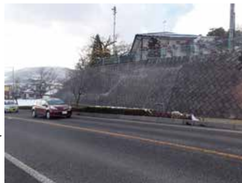
地震対策の検討依頼から約1ヶ月で施工完了。短工期であることもDKボンド工法の特長
