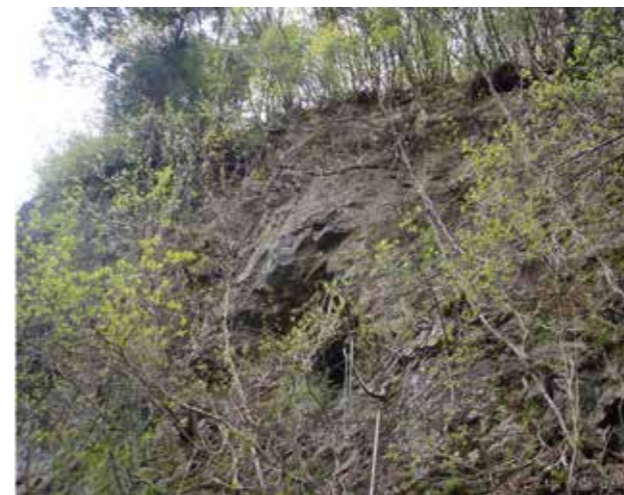
施工前。写真中央部下寄りにオーバーハング箇所がある
