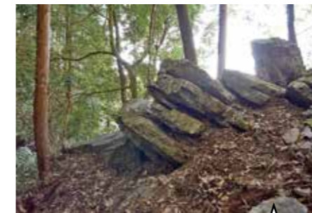
施工前。不安定な岩塊が重なるようにある
