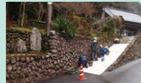
施工時には色が濃かったが、2週間後には白い箇所が目立つ状態に。
