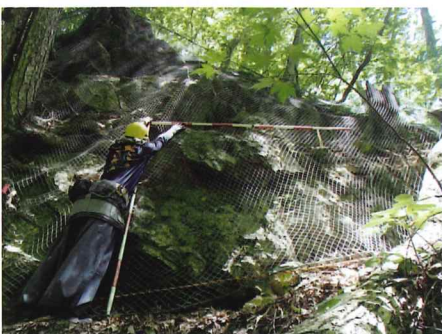
代表部を2m×2mの範囲でピックアップし、施工数量を 算出
