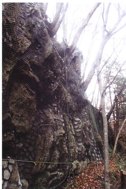
美観を損なわずに岩盤斜面の崩落を防ぐ第1次の施工は完了
