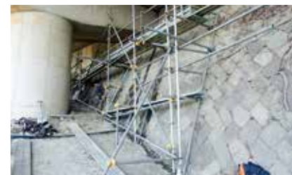
湧水によって黒浜栈道橋の既存石積に空隙が広がり崩落の危険性が。安全対策のために施工箇所に仮設足場を組立ててから、DKボンド工法の本体工事に取り掛かった
