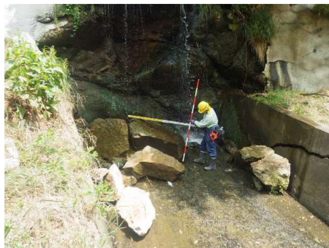
▲崩落した落石の調査
