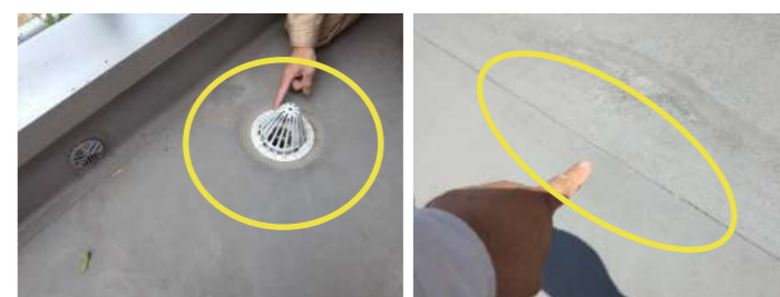
▲ルーフトレンドレン廻りと目地に劣化が見られました。
