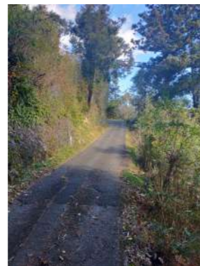
▲落石が発生した現場へと続く山道
