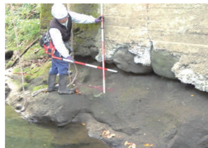
▲ 近くで測定するとかなりの洗掘が進んでいます。
