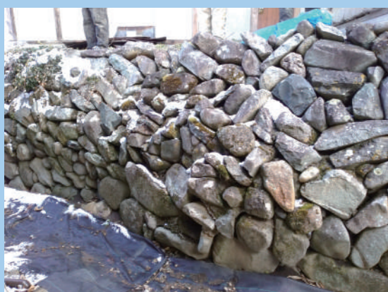
▲大きく膨らんで地盤が下がり危険な状態に！ このままだと崩壊する危険性が！
