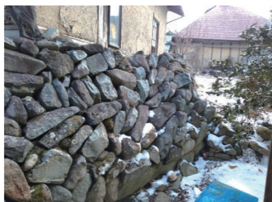
▲不安定な石積みの際には、土蔵が建っており危険な状態です。
