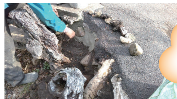
▲場所によっては、既存の石片を一度撤去し、モルタルで下地を調整しながら、再度石片を積み上げます。
