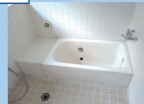
▲タイル貼りの床、壁の入隅などや排水口廻りの目地材の劣化が水漏れの原因に。
