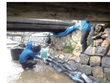
▲小橋下、石積み崩壊状況
