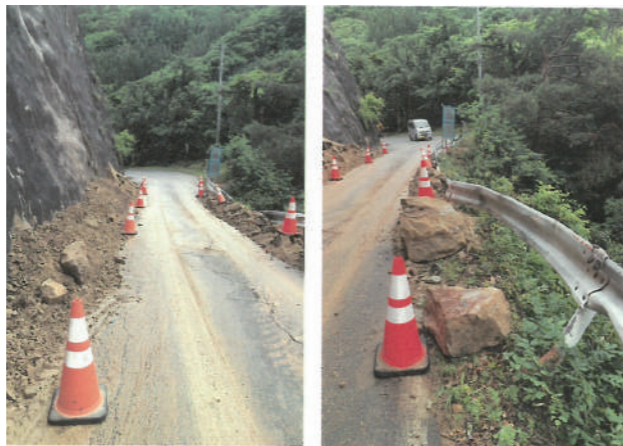
▲斜面上部から剥離した岩塊が道路へ落下しガードレールを損傷。
